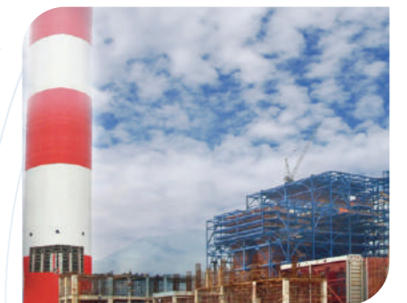
NHÀ MÁY NHIỆT ĐIỆN VŨNG ÁNG
